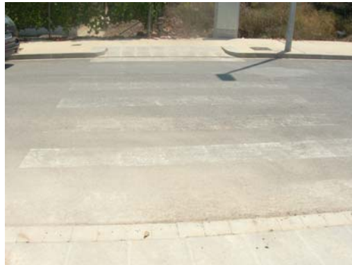
Imatge 2. Pas de vianants pràcticament imperceptible per falta de manteniment
