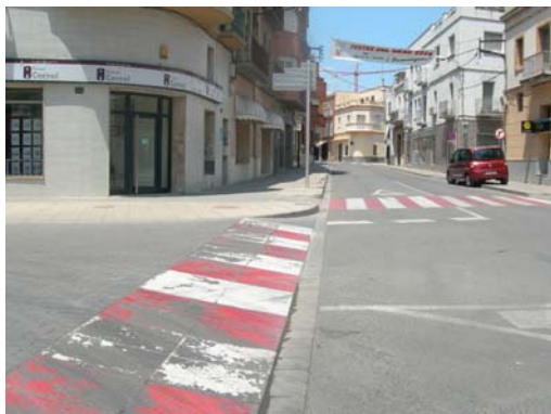
Imatge 1. Delimitació pas de vianants en plataforma esborrat.
